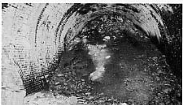
写真13 第七號隧道 内部の崩落(02年12月)
